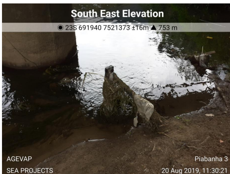
Figura 3.1-12: Régua de nível antes da limpeza.
