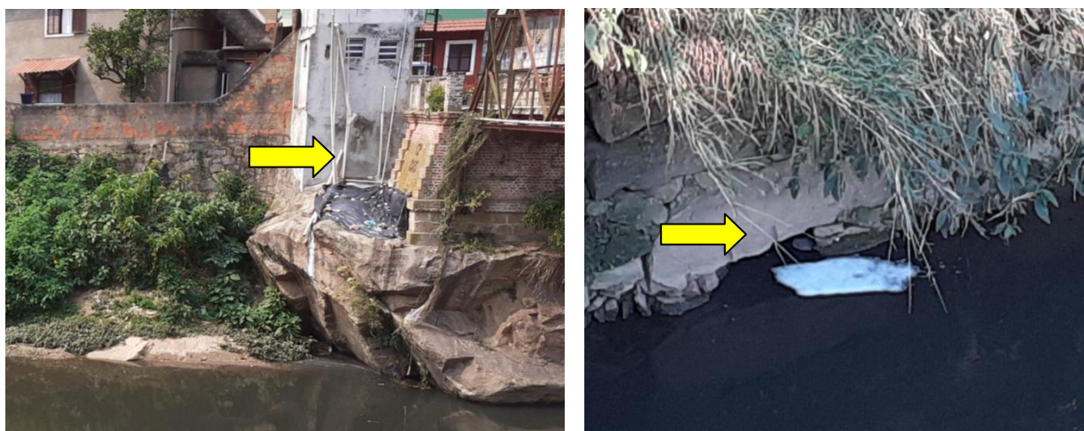
Figuras 3.1-8 e Figura 3.1-9: Visão da margem direita do Ponto 2, detalhes dos lançamentos de esgoto.
